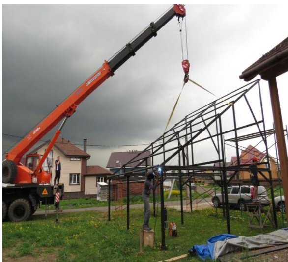
а) этап строительства навеса с солнечными фотоэлектрическими панелями для электромобиля (июнь-сентябрь 2022 года)
